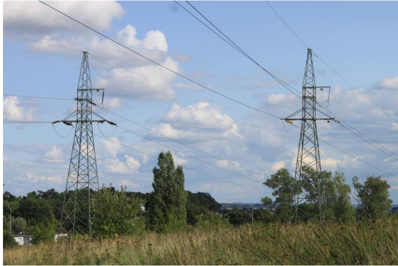
Fot. 56. Linie elektroenergetyczne 110 kV w zachodniej części miasta
